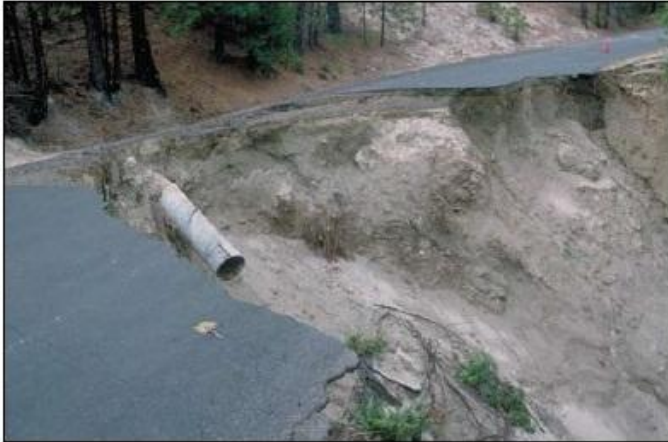
Foto 18: Falla del relleno de un camino en terreno escarpado, para el que ahora se requiere una estructura de contención o un corte alto para retener o ampliar el camino alrededor de la falla.
