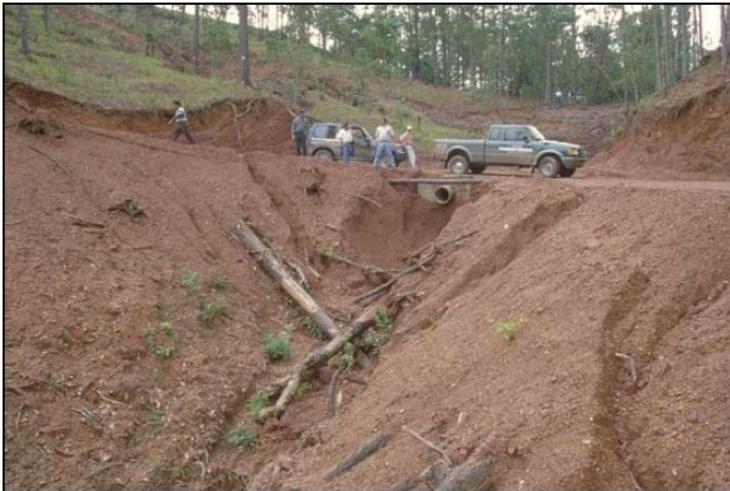
Foto 9: Evite colocar bocas de salida de alcantarillas en la parte media de un talud de terraplén. Use alcantarillas lo suficientemente largas para sobresalir del pie del talud del terraplén, o use estructuras de muros de cabeza para retener el material de relleno y minimizar la longitud del tubo.
