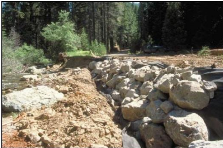
Foto 5: Un enrocamiento de protección con respaldo de un filtro de geotextil están siendo usados para proteger al camino de grandes flujos de agua. Observe que el camino está mal ubicado, muy cerca del arroyo.
