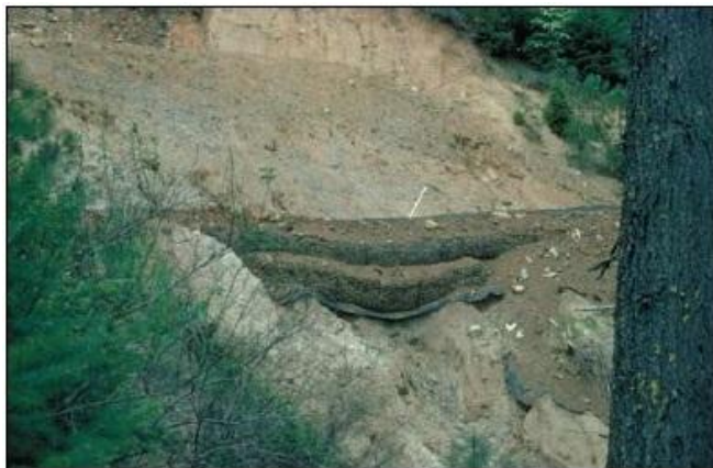
Foto 20: Una estructura de gaviones que fallara pronto debido a falta de una cimentación adecuada. Todas las estructuras de retención, ya sea MSE o muros de gravedad, requieren una buena cimentación.
