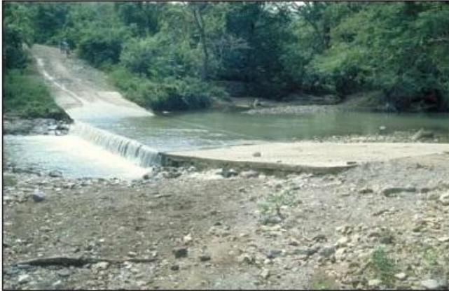
Foto 12: Con vados o cruces en estiaje, el borde aguas debajo de la estructura debe generalmente protegerse contra la socavación, mientras que todo el perímetro mojado (al nivel de aguas máximas) de la calzada debería reforzarse.
